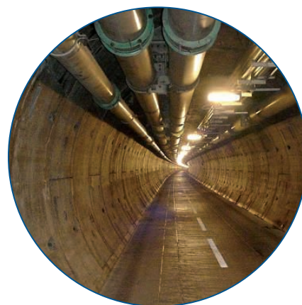
Rys. 6: Tunel serwisowy Photo © Eurotunnel
