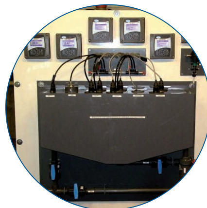
Rys. 5: Stacja monitorowania jakości wody z cyfrowymi przetwornikami i zamontowanymi czujnikami
