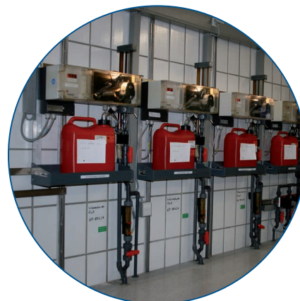
Ilustracja 3: Stacja kontroli czystości z rozbudowaną techniką pomiaru ciągłego
